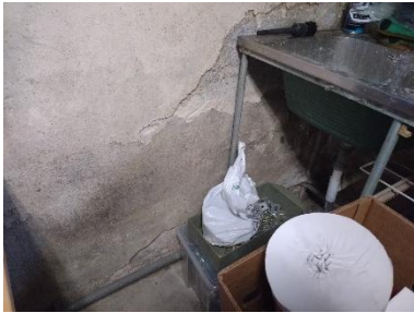
Bild på mineralutfällningar i ytterväggen på källarplan.
