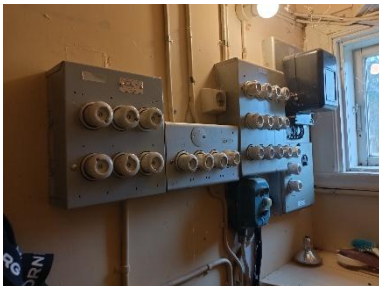
Bild på elcentralen i trappan till källarplan.
