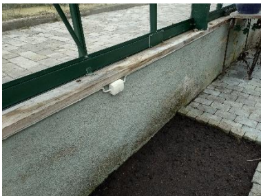
Bild på visst uppsug i grundmuren.
