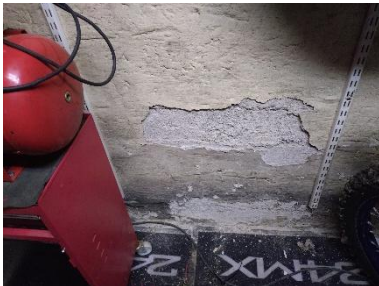
Bild på mineralutfällningar i ytterväggen på källarplan.
