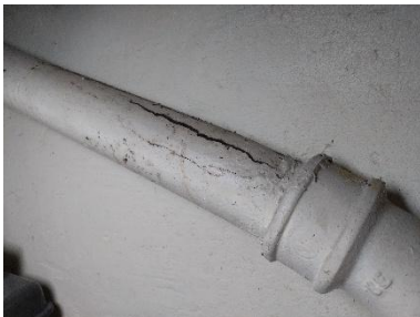
Bild på spricka i avloppsröret.
