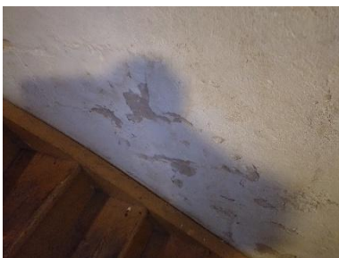
Bild på mineralutfällningar i ytterväggen på källarplan.
