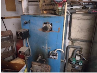
Bild på gamla värmepannan.
