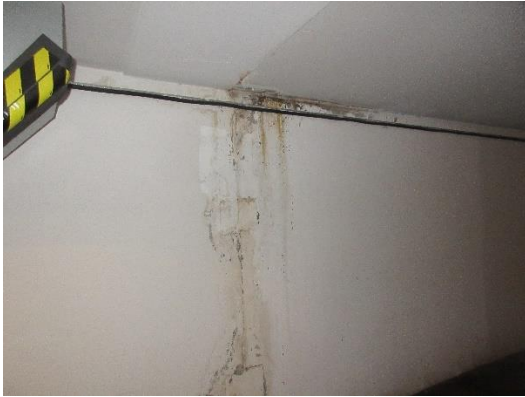
Läckage i garaget
