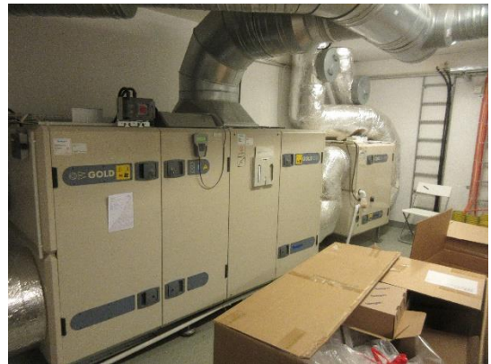
Ventilationsaggregat för allmänna utrymmen
