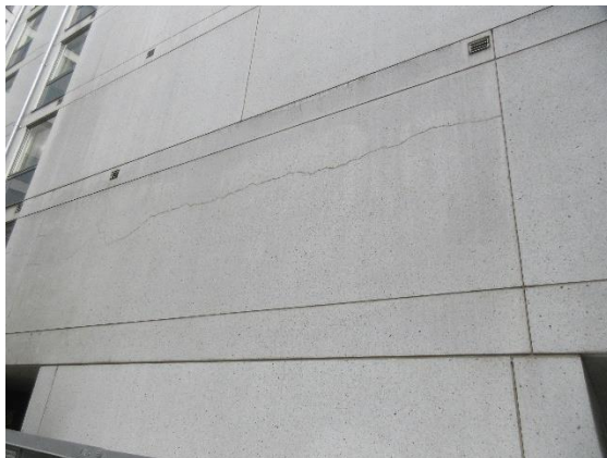
En av många sprickor i fasader
