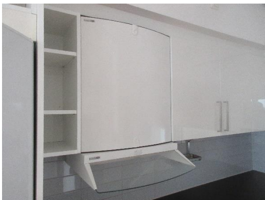
En av flera olika placeringar av ventilationen
