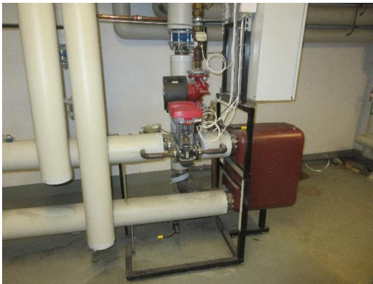
Undercentral för tappvarmvatten
