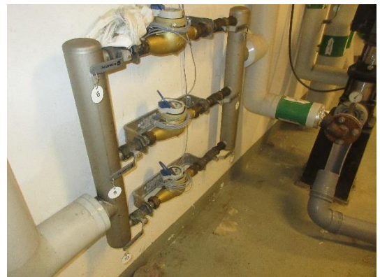
Inkommande vatten i källaren
