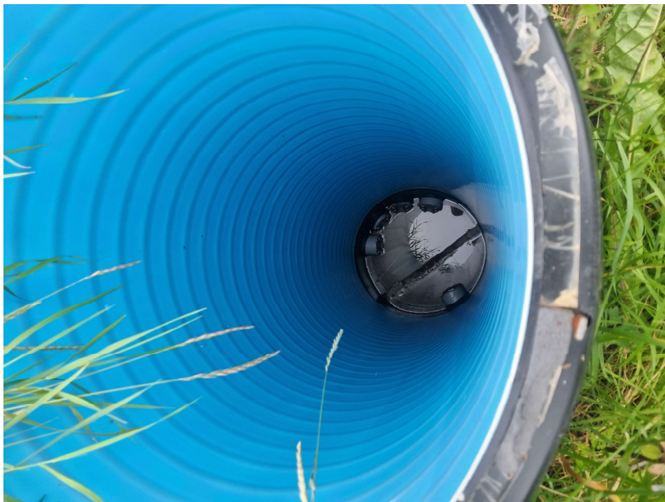
Normal vattennivå och klart vatten i fördelningsbrunn
