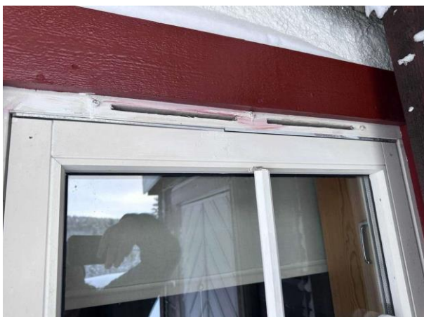
Bild 1: Utvändigt, Fönster, Kåpor för spaltventiler saknas och är spruckna
