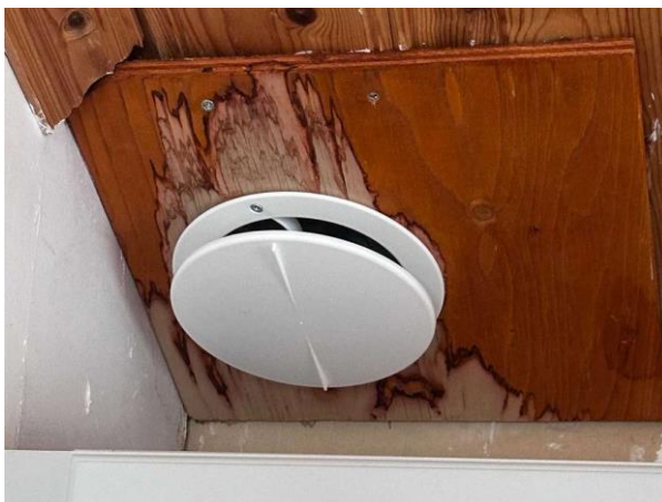
Bild 4: - Invändigt, Entréplan, Droppskydd saknas under kyl/frys Spår av rinning på vägg vid ventil ovanför köksskåp (torr vid b...)
