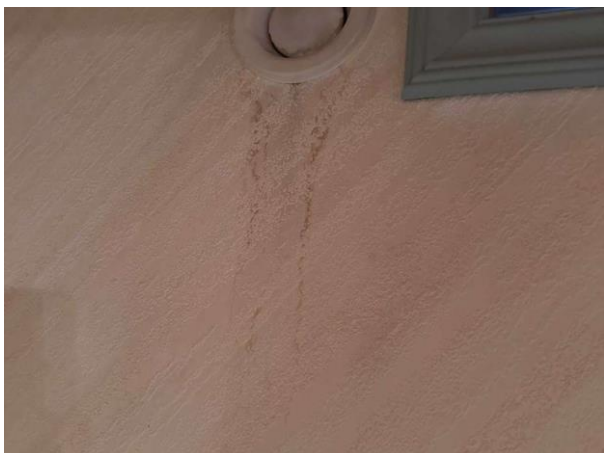
Bild 3: Invändigt, Souterrängplan, Spår av rinning på vägg från ventil noterades (torr vid besiktningen)
