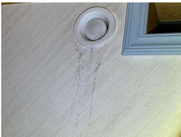
Bild 2: Invändigt, Souterrängplan, Sår av rinning på vägg under ventil (is noterades på ventilen)
