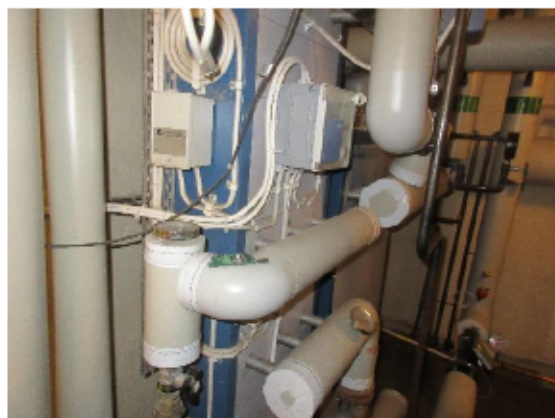
Undercentral fjärrvärme som är uttjänt.
