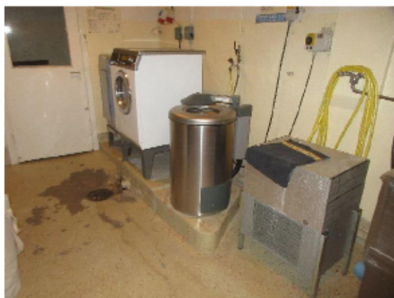
Tvättstuga med underhållsbehov.
