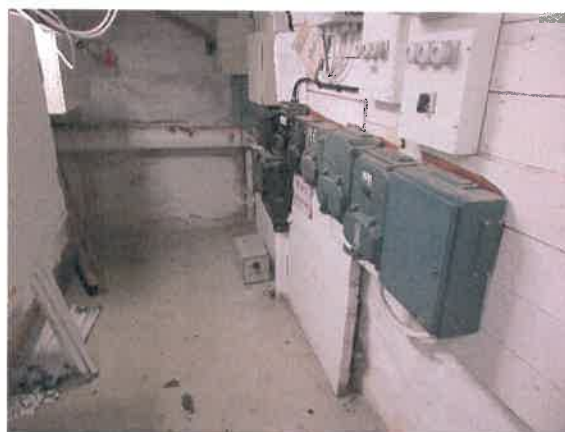
Delar av ej bytta elektriska installationer
