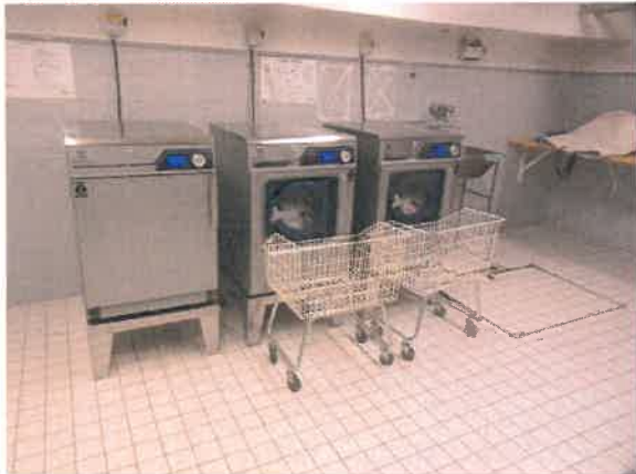
Tvättstugan med nya maskiner
